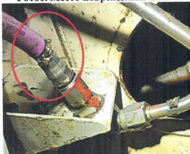
Фото1. Место повреждения шлага
